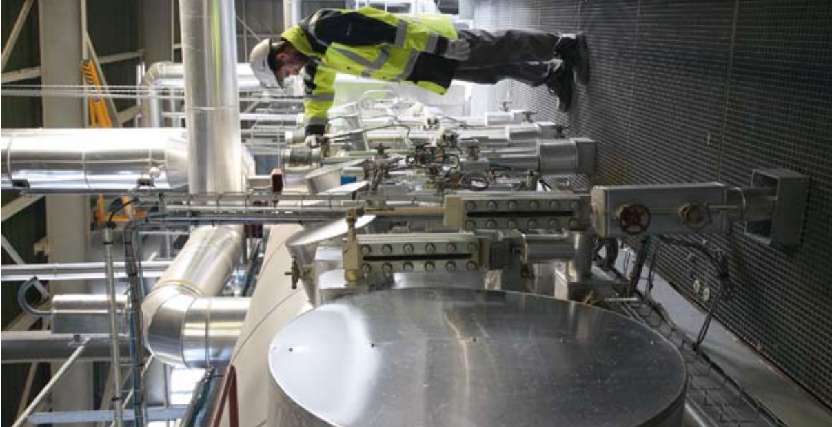
MISE EN PLACE DU TRAITEMENT DES FUMÉES
